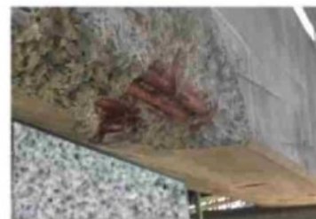
損傷状況(鉄筋露出)
