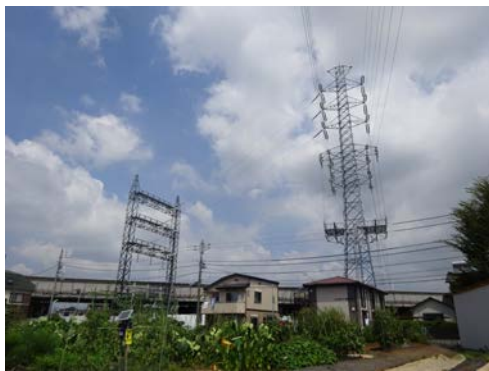
図5 外環工事ヤードにある門形鉄塔(左)と川世線の鉄塔(右)奥に見えるのが東名高速道路。工事中は66000ボルトを受電しています。
