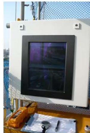
監視台②モニタ画面 (カメラ①③) 発進指示信号制御機
