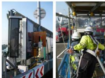
・本線走行速度センサー ・速度LED表示板
