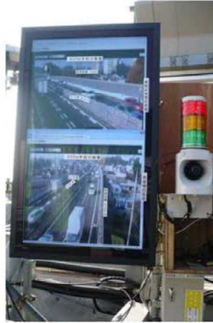
運転手用モニター画面 (カメラ①③) 発進指示信号機&プザー
