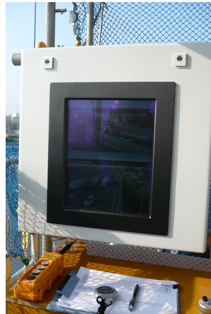
監視台②モニター画面 (カメラ①③) 発進指示信号制御機
